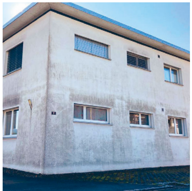
Putzfassade mit Algen-, Flechtenbefall
