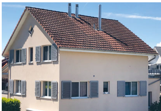
Dach mit Algen-, Flechtenbefall
