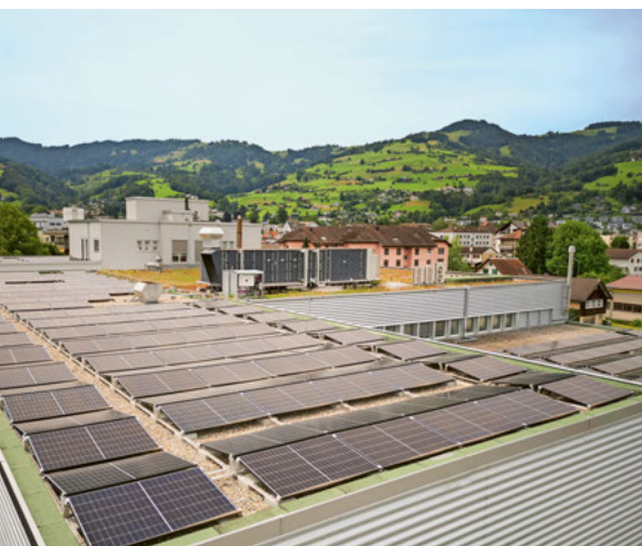
Solaranlage mit 370 MWh Leistung
